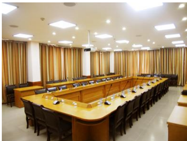
Hình 2: Hệ thống chiếu sáng phòng họp/hội thảo tầng 3 nhà 2A. Khu Công nghệ Nghĩa Đô - Viện KH&CNVN sử dụng đèn LED panel và đèn LED spot light của FawooKiDi
